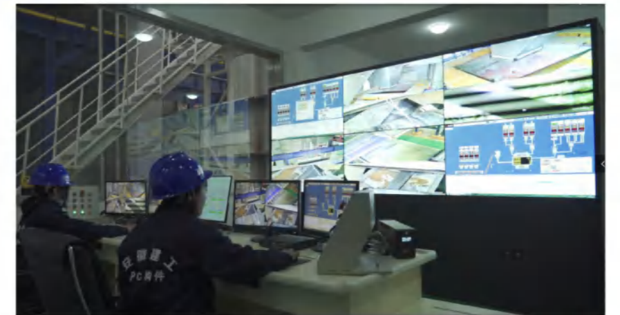
▲ 安徽建工智能建造信息化控制系统
